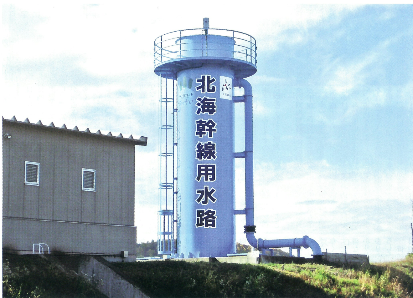
『赤平市新住吉揚水機 サージタンク』
